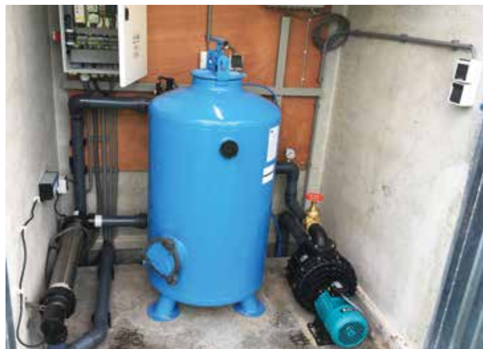
Oppervlaktewater wordt behandeld met een filter en uv-lamp.
