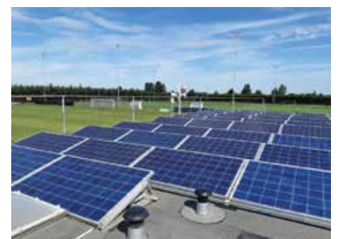
Zonnepanelen op kantinedak (ter illustratie)
