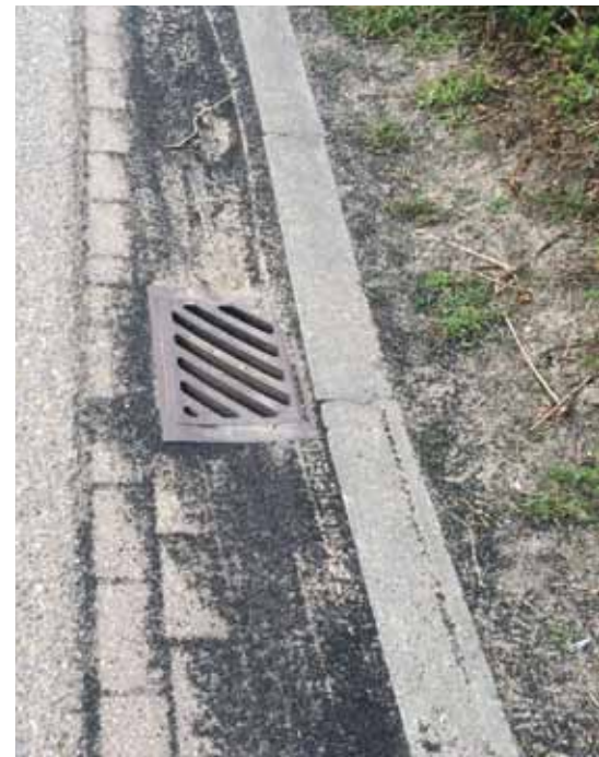
Infil stroomt bij overvloedige regen zo de rioolput in.
