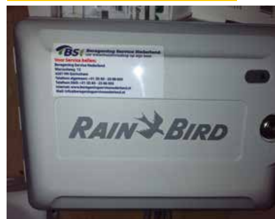
De bestaande beregeningsautomaat werd vervangen voor een RainBird ESP-ME, waarmee de beregening middels een app kan worden aangestuurd.
