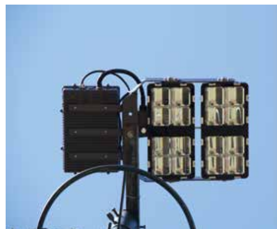
Close-up van de armaturen
