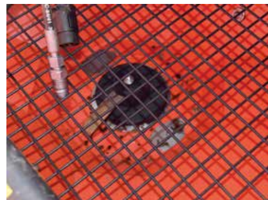
Twee elektrisch bediende toevoerschijven in de taps toelopende bak
