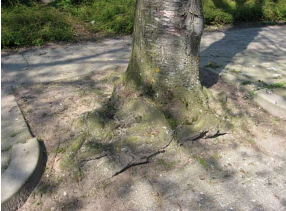
Een van de grootste problemen vormt de trottoirpdruk door boomwortels. Hier zijn stoeptegels weggehaald die anders naar boven waren omgebogen.
